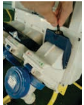
Bloqueio com fechadura
